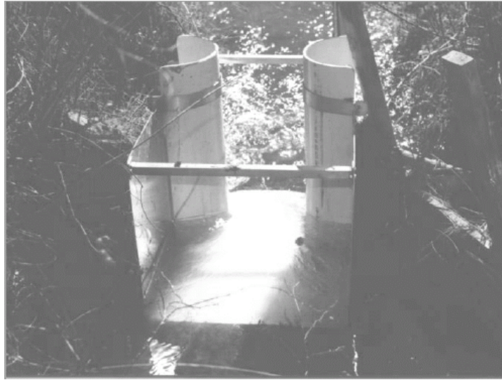
รูปที่ 14-33 แสดง S-M Flume ที่ติดตั้งเพื่อวัดน้ำในคูน้ำ
