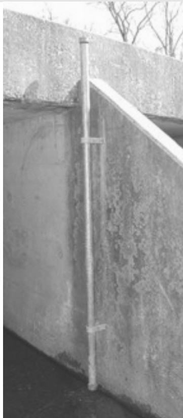
รูปที่ 3-25 เครื่องวัดระดับน้ำสูงสุด และลักษณะการติดตั้ง
